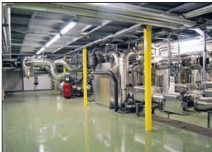
Nova centralna energetska postaja v objektu Koroška 3a - spuščena v pogon 2007
