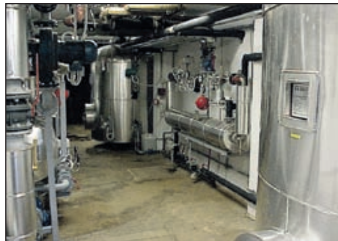
Toplotna predajna postaja (TPP) na sistemu daljinskega ogrevanja
