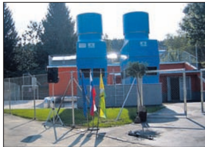
Otvoritev nove absorpcijske hladilne postaje za daljinsko hlajenje avgusta 2008
