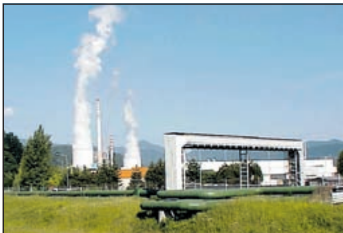
vročevodni dovod od TEŠ do Velenja, zgrajen v letih sedemdesetih in osemdesetih letih prejšnjega stoletja, pretežno obnovljen od 1996 do 2007
