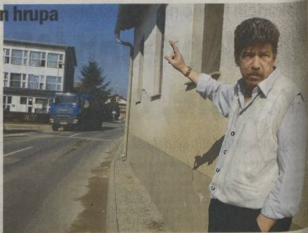
Nuhija Ademsafi živi tu, v hiši ob cesti, že 25 let: »Zelo hudo je. Pred štirimi leti sem si prepletkal fasado, sedaj pa je poškopljena in uničena. Na okna hiše smo si morali dati zaščito, saj je na drugi strani kuhinja, kamor gre ves prah. Lani smo kuhinjo obnovili, sedaj pa glejte, kako tresljave so nam popokale ploščice. Že pred časom so mi šleperji uničili žlebove, sedaj pa še fasado. Blato in pesek, ki se nabirata ob cesti, moramo sami čistiti vsak dan.
