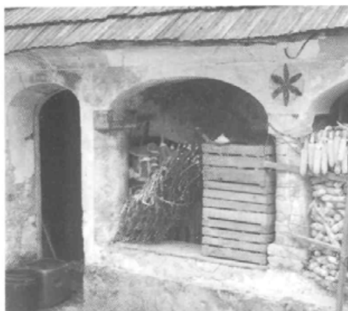
365. Pri "Andrejčkovih" na Mirkah, v neposredni bližini Verda, so ohranjene raznobarvne šesteroliste zvezde na pročelju arkadnega svinjaka.
