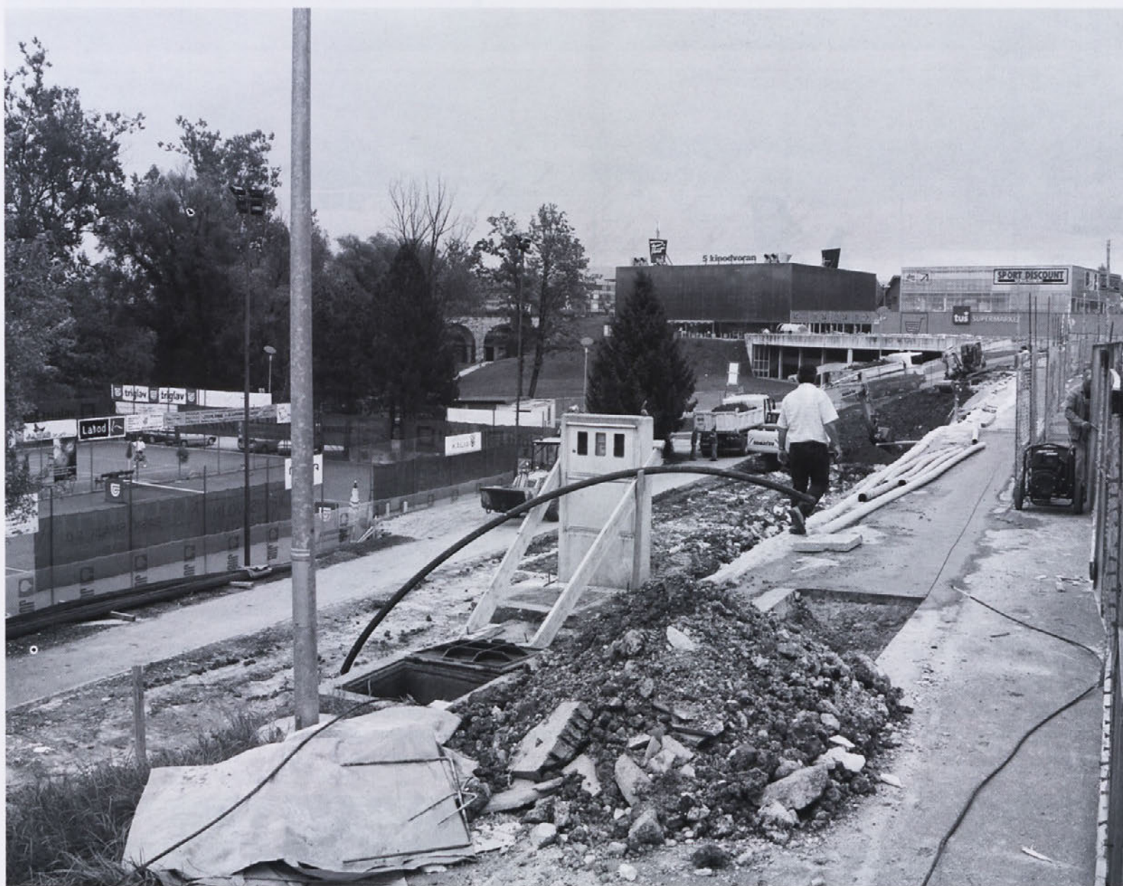
Kako naporno je investiranje v novomeške športne objekte, se kaže na številnih primerih. Brodolom velodroma je morda največji tak primer, eden zadnjih primerov pa je tako imenovani servisni objekt za tenis v Portovalu. Njegove gradnje se je občina lotila leta 2007. Še danes je nedokončan. In ne kaže, da bo kaj kmalu drugače.
