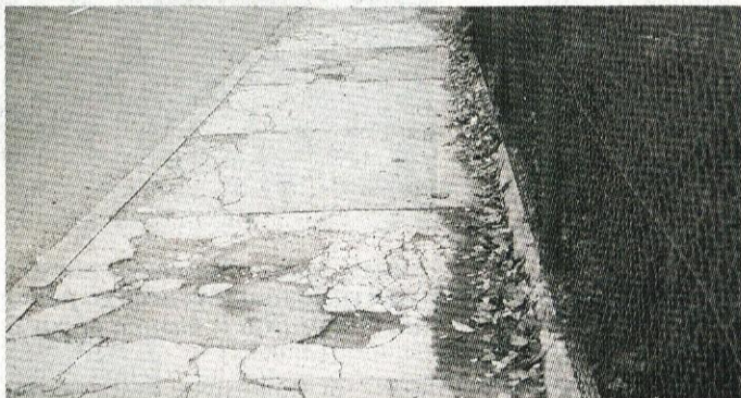
Dotrajan pločnik med železniško postajo in pekarno bo končno dočkal obnovo.
