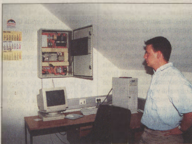
Borut Kuprivec, pomočnik vodje PE Vodovod v okviru Komunale Lendava, lahko nadzoruje ves vodovodni sistem iz pisarne v Lendavi.
