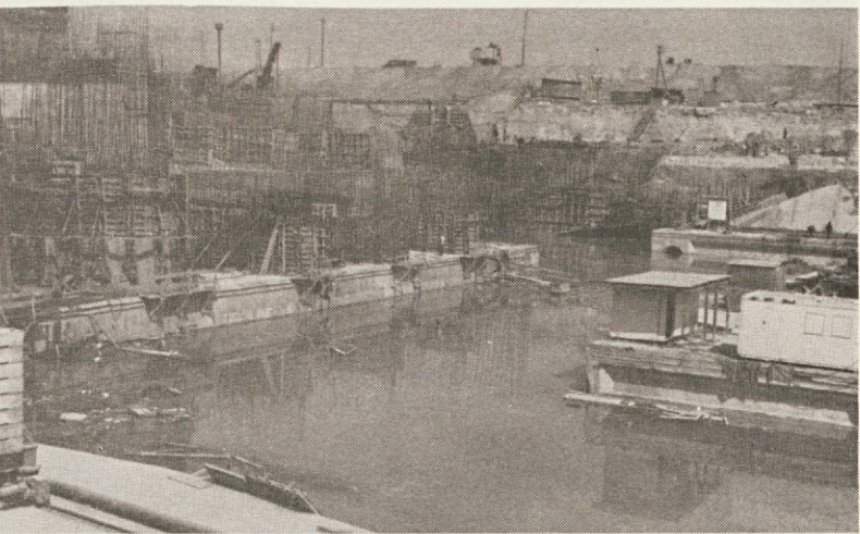
28. februarja smo doživeli prvo poplavo gradbene jame, pred katero smo zadnji trenutek uspešno rešili vse naše naprave in orodje. Poplava je nastala zaradi udara vode skozi levo bočno steno gradbene jame, ker so Rusi, graditelji jeza, preusmerjali tok reke Evfrat (Foto: A. Razpotnik)
