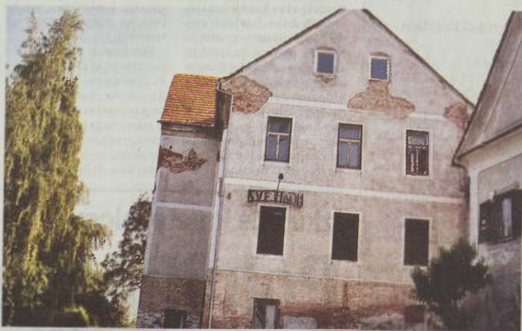
Šola na Svetinjah že več let čaka na investitorja, ki jo bo rešil pred dokončnim razpadom. Foto: D. H.
