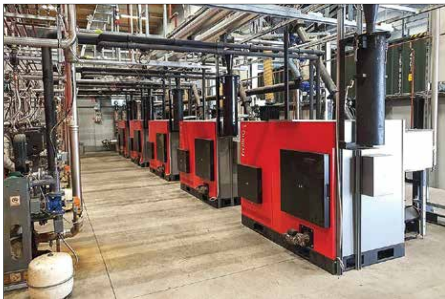
V Biomasinem centru v Nazarjah deluje 12 naprav kogeneracije s skupno 550 kW električne in 1200 kW toplotne moči.
