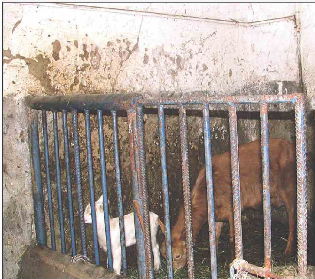
V hlevu že močno poka. Če se bo to še nadaljevalo, ga bo težko popraviti. Zaenkrat pa za živino stavba še ni nevarna.
