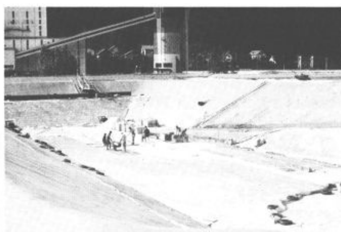
Zaprta krogotok tehnoloških voda je velika pridobitev za celotno Šaleško dolino, saj šoštanska termoelektrarna odselej ne bo več onesnaževala voda.
