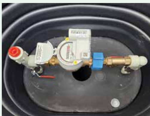
Slika: Vodomerni jašek z vodomernim števcem
