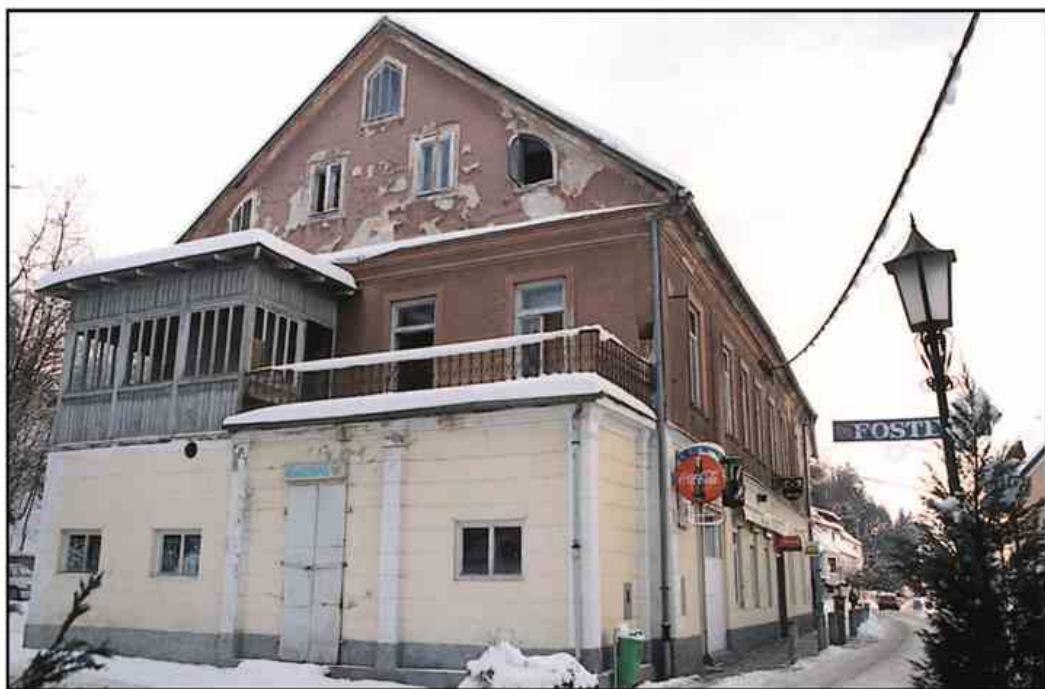
Dotrajan in nevaren objekt
