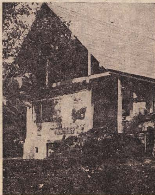
Korenjetova hiša je letos dobila opečnato streho, ker je prejšnja, slamnata, že puščala. Ker pa je zmanjkalo denarja, je hiša ostala na obeh straneh odprta. Tam, kjer je okno, je izba, v kateri živi 6-članska družina. Nad stropom prepih, ob strani razpokane deske. Gorje ko bo sneg...
