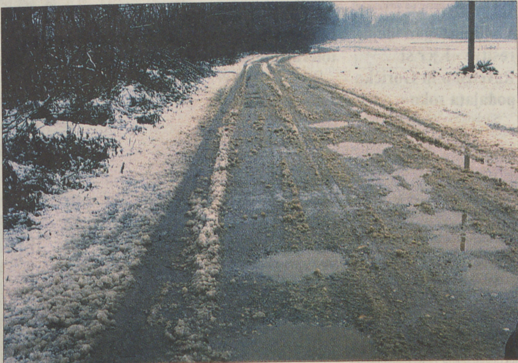
Marsikatero pomembno lokalno povezavo so iz takšnih in drugačnih razlogov »izvisele«, ne le da so ostale neasfaltirane, ampak jih niti ne vzdržujejo tako, da bi bila zagotovljena prometna varnost, kot tole v občini Moravske Toplice. Posnetek je nastal po prvem snegu.
