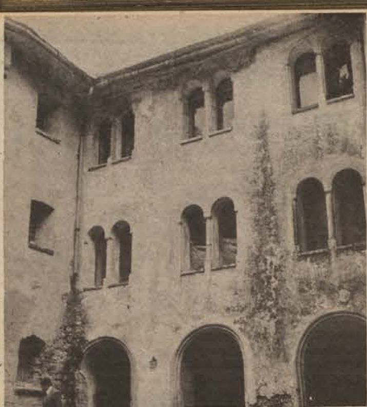
Skozi streho piščekga gradu curi dež. Stanovanci se pritožujejo, da Stanovanjsko podjetje pobira najemnino, za popravilo pa se ne zmeni. (Foto: J. Teppey)
