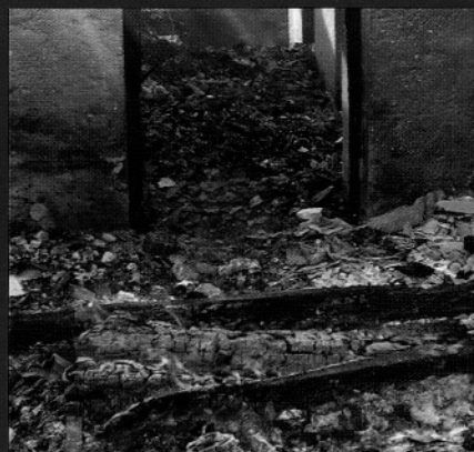
Na pogorišču so še vedno goreli leseni tramovi (foto: Štefi Sem)
