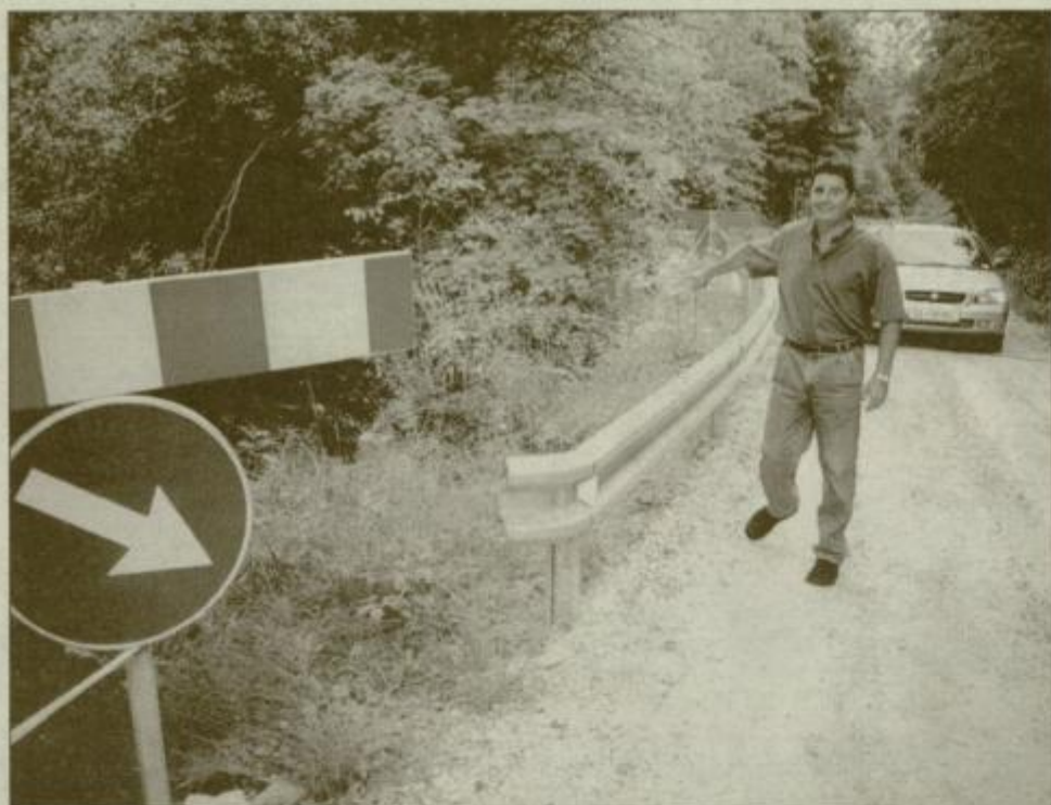
Mirko Zamernik kaže spodkopani cestni propust, ki lahko potegne v globino velik del cestišča.
