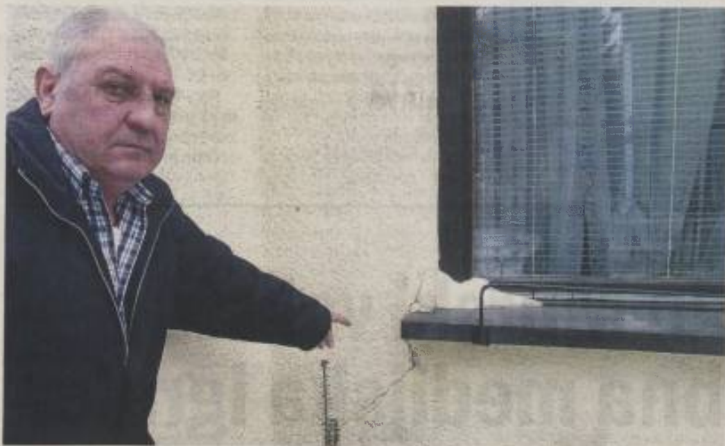
Zaradi tresljajev, ki jih povzroča tovorni promet, pokajo stene. V krajevni skupnosti Dolnji Lakoš bodo popisali škodo, prizadetim krajanom pa svetovali, da terjajo odškodnino.
