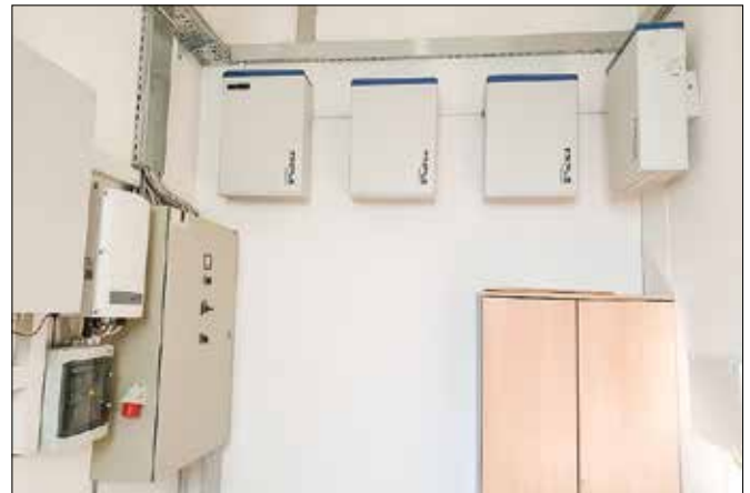
Primer inštalacije hišnih baterij
