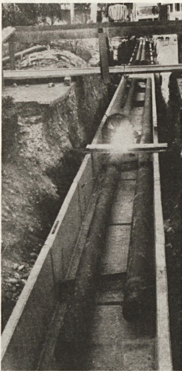
Napeljava ogrevanja v samskem domu na Djakovičevi 10 (Foto: J. Jereb)
