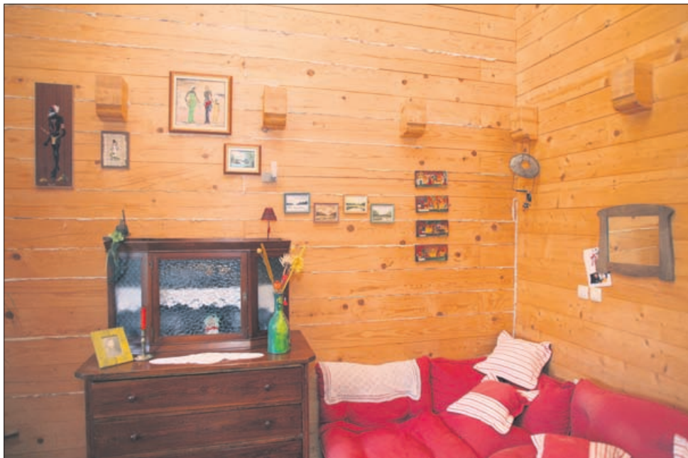
Prijetno notranjost hiše kazijo cunje, s katerimi je lastnica zatlačila tudi do prst debele špranje med bruni. Graditelj hiše je povedal, da je to nekaj normalnega. Investitorka naj bi bila nad naravnim vzorcem razpokanega lesa celo navdušena.
