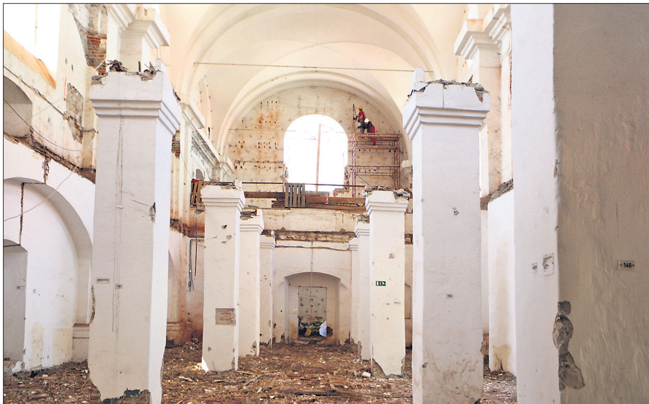
Zaradi dotrajnosti so se sesuli steber, del oboka in stropa v prehodu na južno dvorišče dominikanskega samostana. Do sesutja je po vsej verjetnosti prišlo zaradi dotrajnosti.
