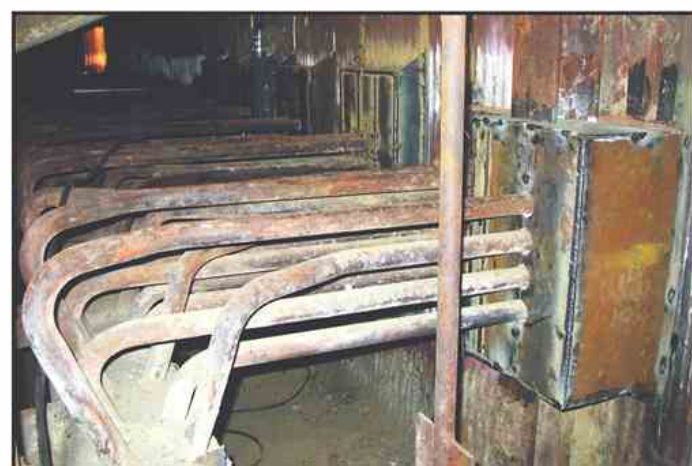
Takole zgledajo cevi po dolgoletni uporabi. Treba jih bo zamenjati.
