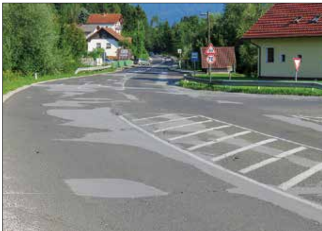
Dotrajana cesta v križišču v Radmirju, kjer bo država gradila krožno križišče. Občina Ljubno bo ob tem izvedla še javno infrastrukturo.
