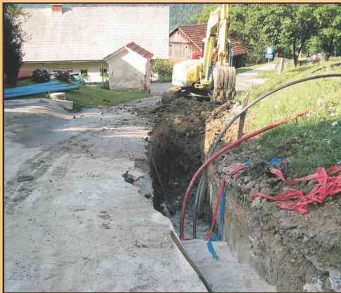
Vodovod Vinska Gora
