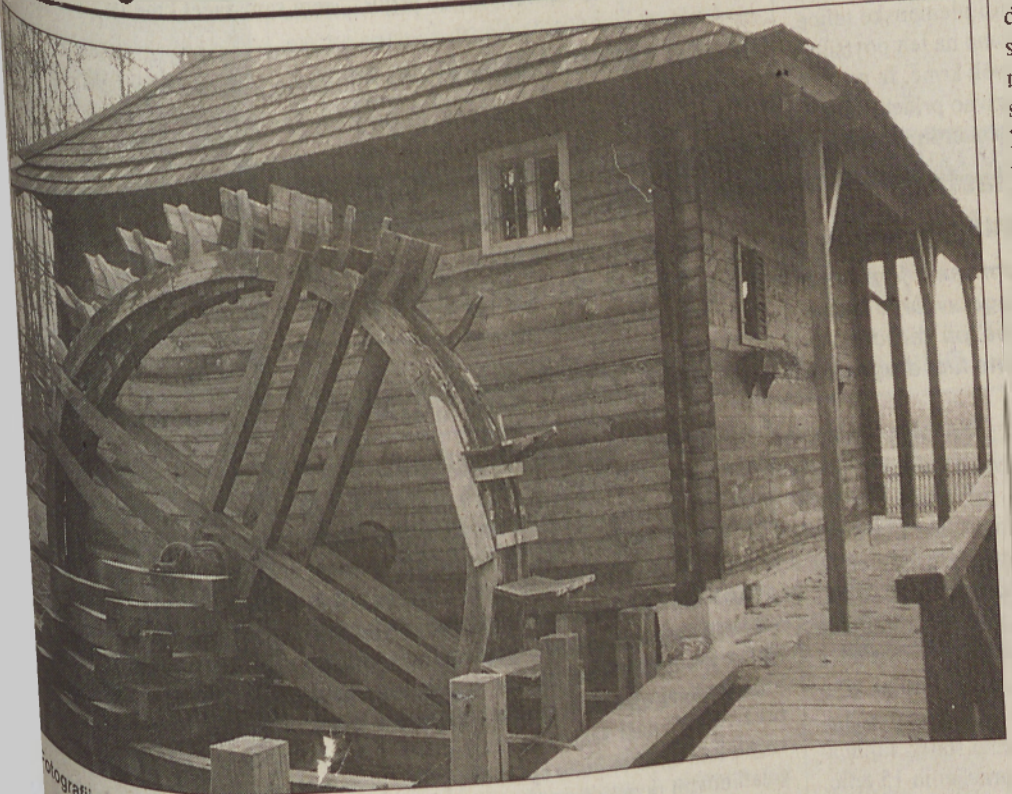
Fotografija: Copekov mlin: razbita okna, polomljeno kolo ...
