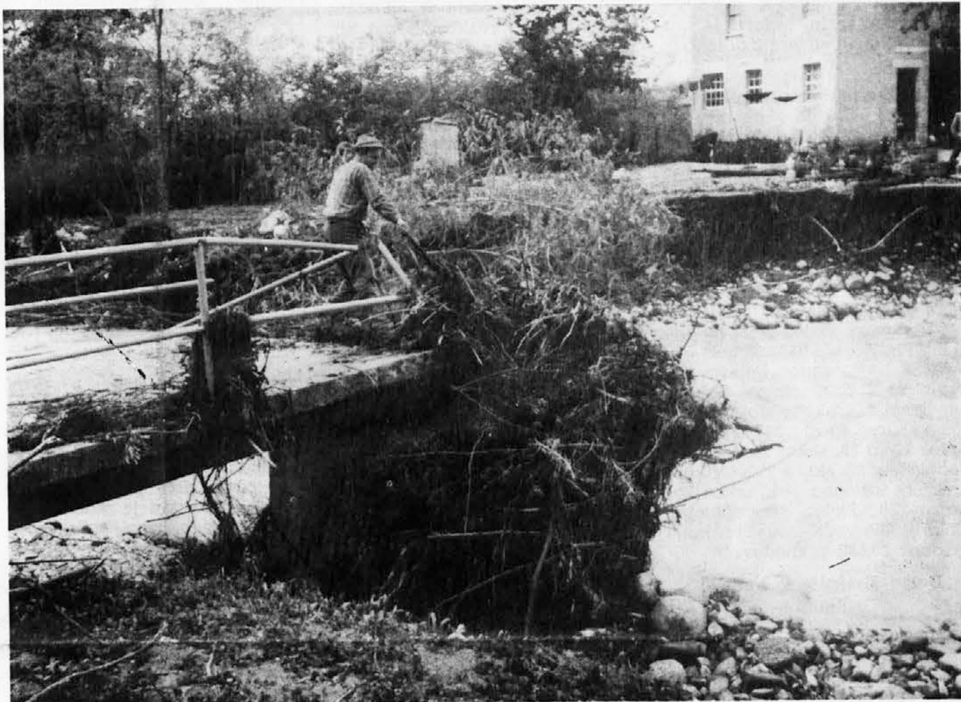
Blizu Fojde je silovita vodna besnost odnesla skoraj cel most; ostala je le ena arkada in še ta je v nevarnosti, da jo kmalu odnese voda. Sedaj je odrezanih od glavnega centra več desetih družin.
