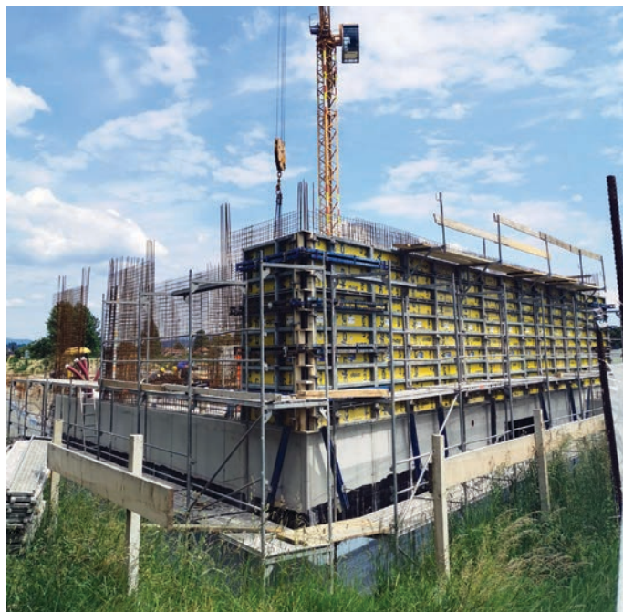
Včasih kaj tudi ni šlo po načrtu, a po zagotovilih projektantov in izvajalcev so nekateri popravki pri gradnji običajni in predvidljivi.
