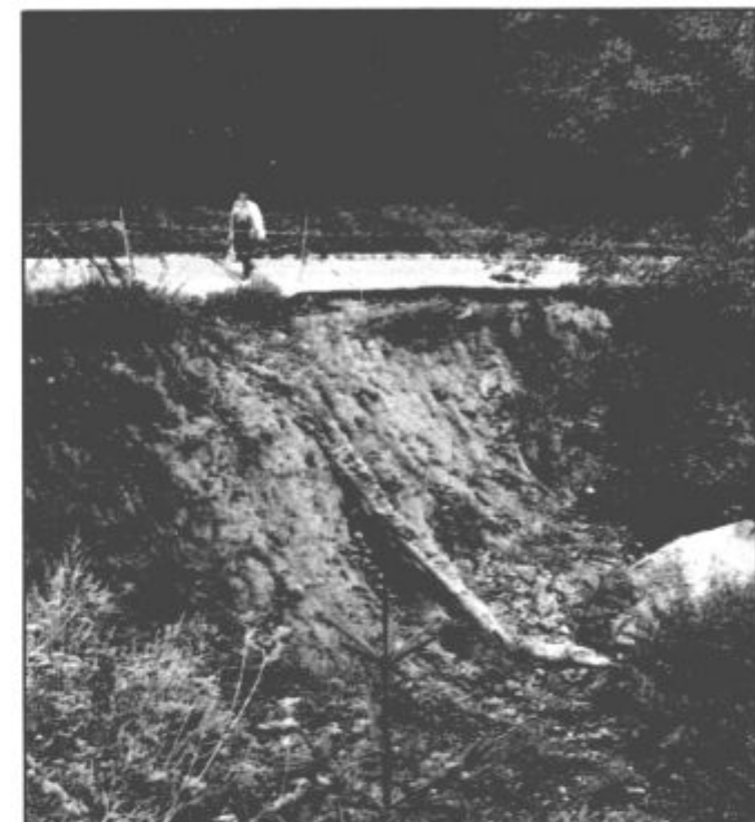
Na stari cesti od Starega Velenja proti Kavčam, malo nad Praprotniki, je plaz odnesel del cestišča in dobršen del hriba. Krajski upajo, da bo sanacija kmalu stekla, saj se bojijo jeseni. (foto: vos)
