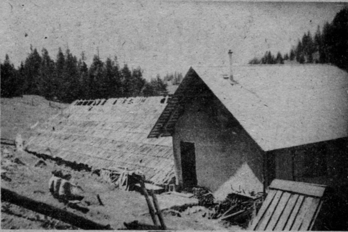
Tudi zgradba na Menini je potrebna popravila
