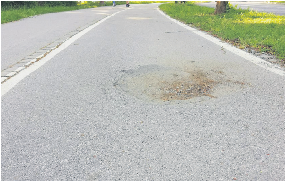
Udarne jame na kolesarskih stezah, ki so lahko izredno nevarne, če kolesar zapelje vanje, niso redkost. Ena takšnih je točno pred celjsko policijsko upravo.
