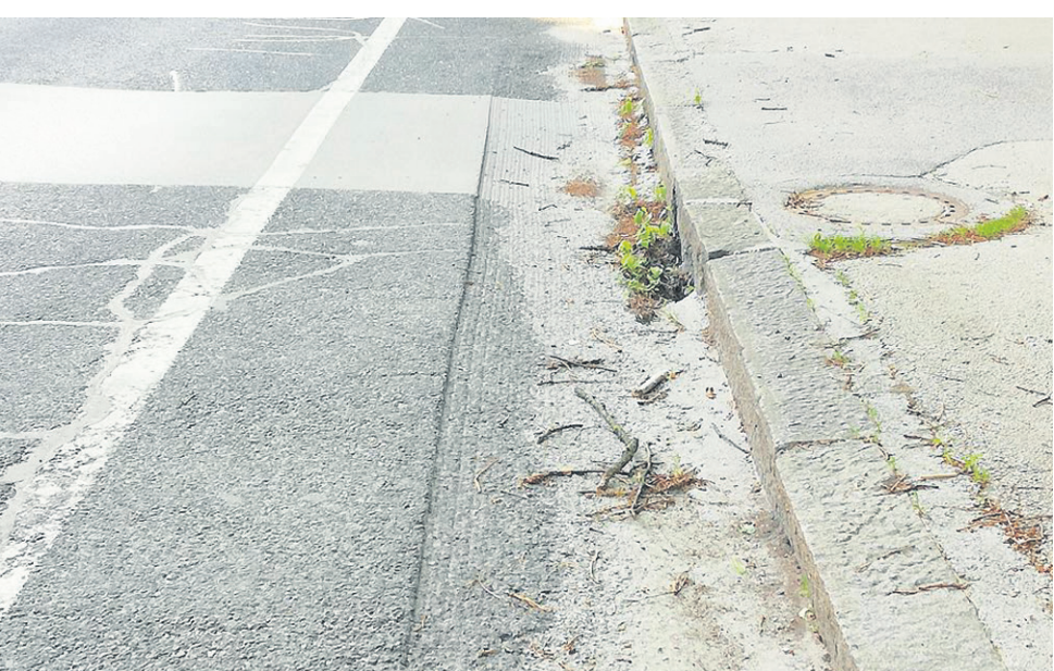
Skrajno nevarna situacija bi se zgodila na kolesarski stezi ob eni najbolj prometnih cest v Celju, če bi kolesarja na robu takšne podlage zaneslo.
