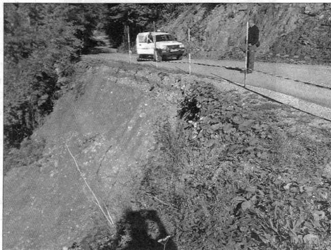
Plaz pod cesto Zavodice-Čreta bo zahteval čimprejšnjo sanacijo
