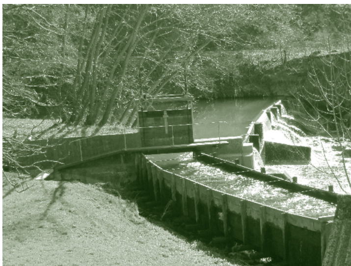
Slika 2: Jez, glavna zapornica in dotočni kanal
