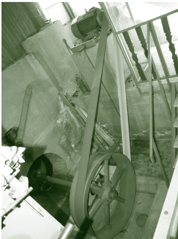
Slika 5: Mala turbina s prenosom na generator
