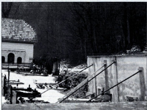
Oporni zid se je žuril zaradi neustreznega temeljenja, ob tem pa uničil dva spomenika.
