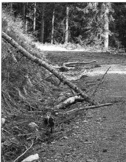
Sečni ostanki v odtočnih jarkih povzročajo poškodbe cest ob nalivih in tratijo skromna sredstva namenjena vzdrževanju gozdnih cest.
