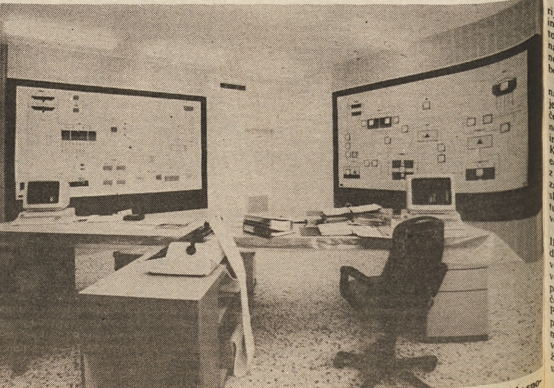
Eden od 1.210 objektov na Projektu je vodno zajetje. Zgoraj pogled v črpališče, v sredini zunanost in spodaj komanda, ki je popolnoma avtomatizirana, vodi pa jo računalnik. Tudi ta objekt je opremljen z najsoodobnejšo opremo.
