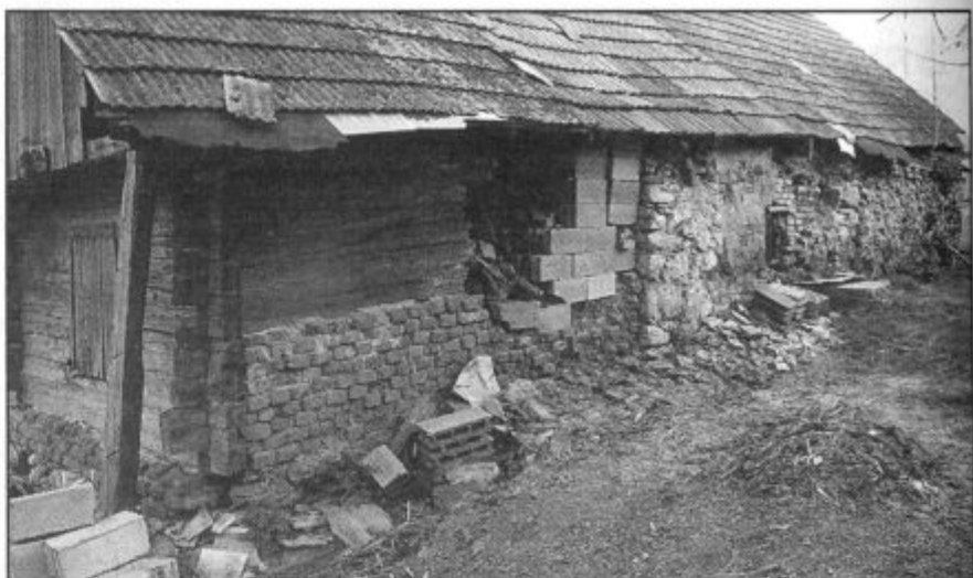
Pogled na zadnjo steno doma je več kot zgovoren. Nekateri krajan menijo, da je tudi spomeniško varstvo veliko prispevalo, da je hiša tako končala.
