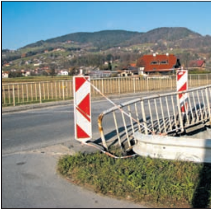
Poškodovao graja nap oškodovanem ostu
