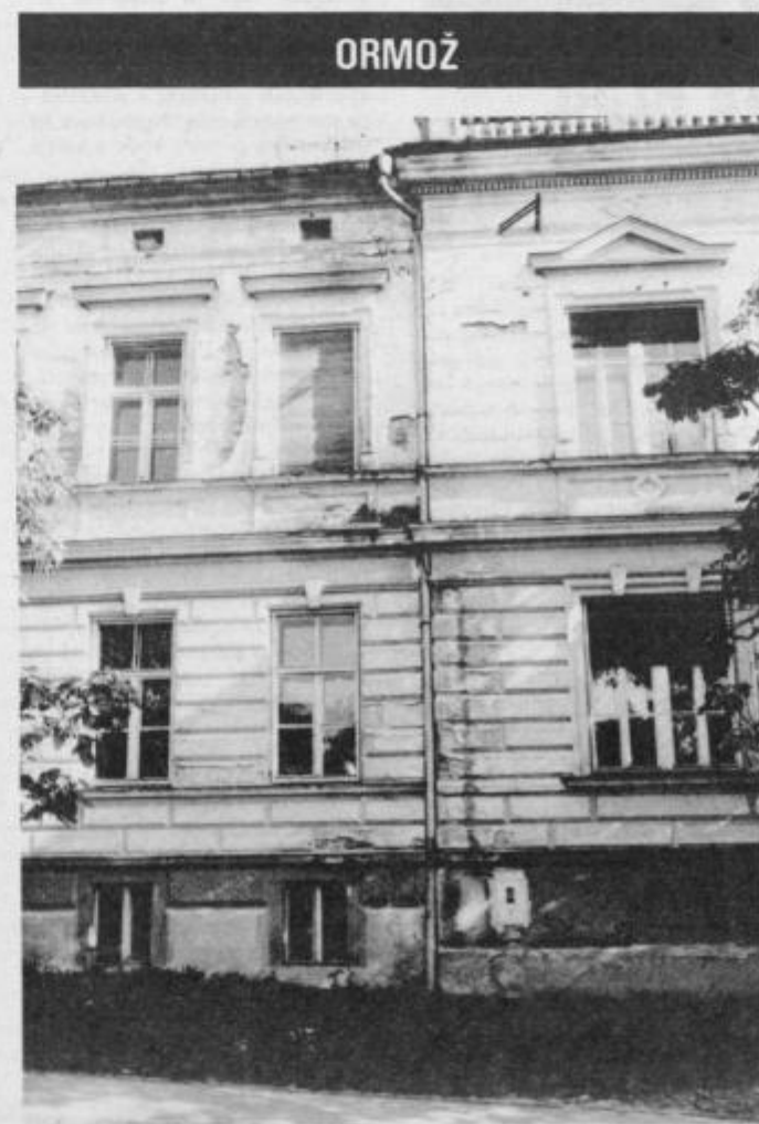
Pogled na razpadajočo fasado.
