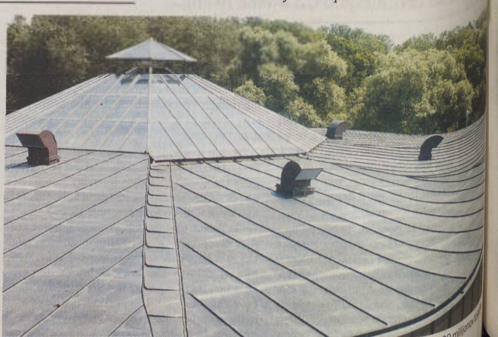
Problematična streha radenskega kopališča, ki je staro šele sedem let - njena sanacija bo stala najmanj 100 milijonov tolarjev
