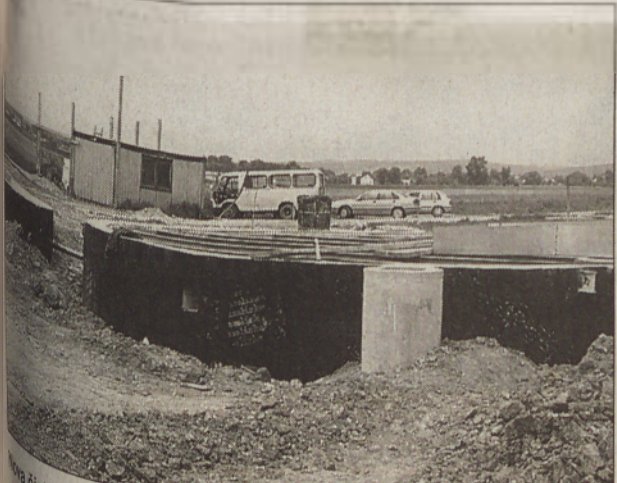
Čistilna naprava na Ivancih
