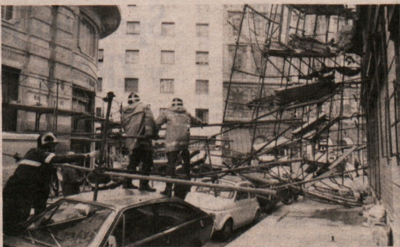
Štirje na srečo lažje ranjeni in osem poškodovanih avtomobilov je obračun slikovite nesreče v središču Trsta, kjer se je večnadstropni zidarski oder sesul na cesto
