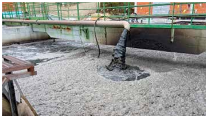
Dodajanje zraka v začasni bazen za čiščenje odpadnih voda
