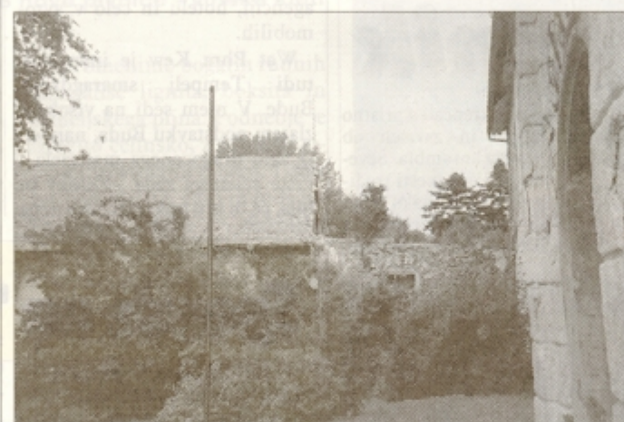
Pogled na nekdanji gospodarski del je vse prej kot obetaven, saj je del nekdanjih hlevov že v ruševinah, (Foto: VT)
