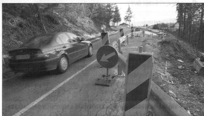
Ali nova cestna zapora na gorenjskem klanecu v Ljubiji naznanja sanacijo plazu? (foto: Jože Miklavc)
