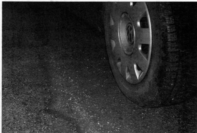
Cestišče je na mnogih mestih poškodovano, polno deformacij in neravnin (foto: Benjamin Kanjir)
