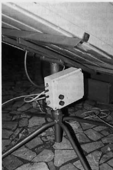
Elektronski regulator in elektromotor sta montirana na nosilcu sončnega topilnika.
