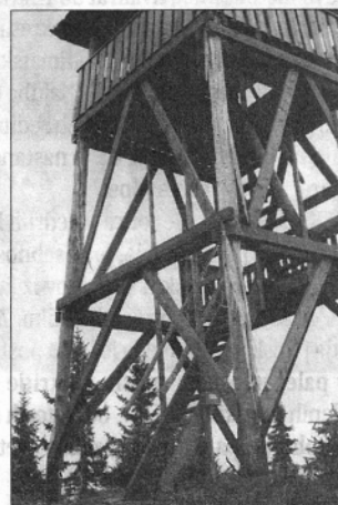
Poškodovan razgledni stolp (foto: Franjo Atelšek)
