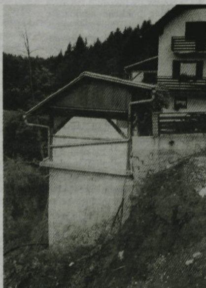
Plaz ogroža hišo v Soteski
